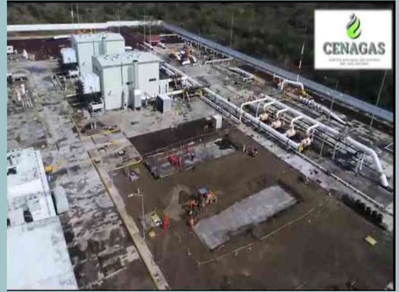
Estación de compresión
